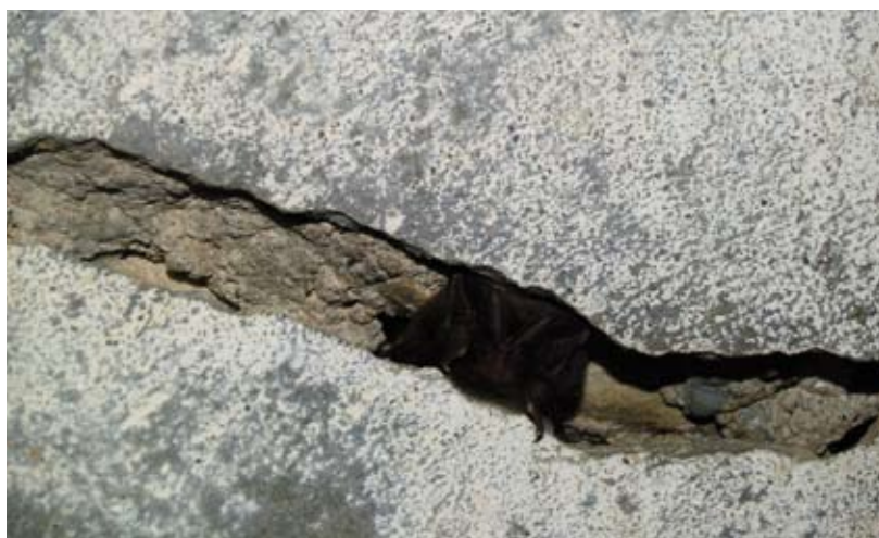
Szczelina w stropie poterny z zimującym mopkiem (T.M.)
